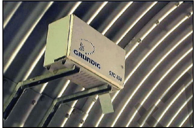
Abb. 2.1.129: Der Sensor im Tunnel 2017.
