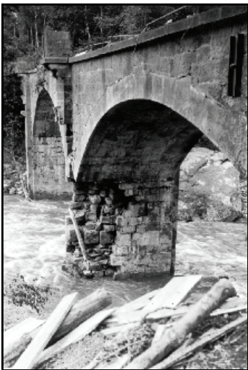
Abb. 9.1.22: Die 1927 beschädigte Eisenbahnbrücke oberhalb von Langenhennersdorf
