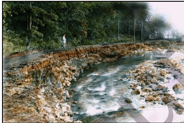
Abb. 9.3.9: Schäden an der Talstraße bei Bahra 1958. Foto: Kegel, W., Langenhennersdorf.
