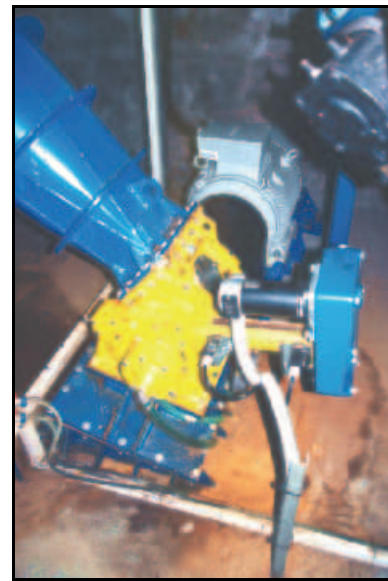
Abb. 9.1.150: Die Kleinwasserkraftanlage 2007 mit 20 kW.
