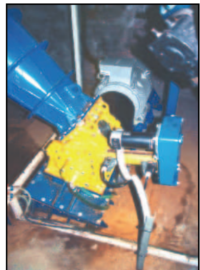
Abb. 3.73: Die kleinere der zwei Wasserturbinen.
