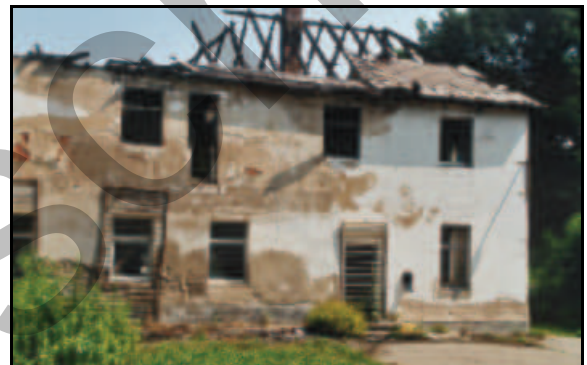
Abb. 4.50: Die Ruine des letzten Gebäudes der Lindigtmühle in Pirna 2006.
