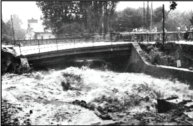
Abb. 5.1.83: Die wichtige Straßenbrücke am Bahnhof ist stark beschädigt. Samml. Christian Trachbrodt.
